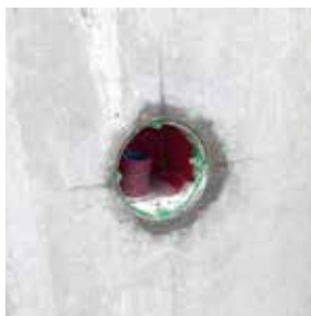
Elektrodosen inkl. Leerrohre
